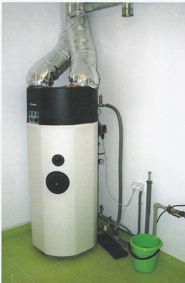
Inštalované tepelné čerpadlo s 290 l zásobníkom „rekuperuje“ teplo z odsávaného vzduchu do ohriatej pitnej vody. Cez zimu sa časť tepla využíva aj na vykurovanie kúpeľní. Tým sa zabezpečuje nepretržitý chod tepelného čerpadla 20 hodín denne.
